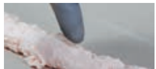
Velvorming, lijm voelt droog aan, te laat, opnieuw lijm aanbrengen
